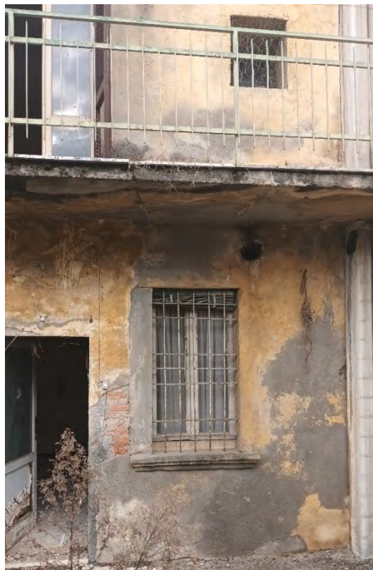
Figure 14: facciata corte interna. Vista: serramenti esistenti-inferriate-degradi mat. lapidei
