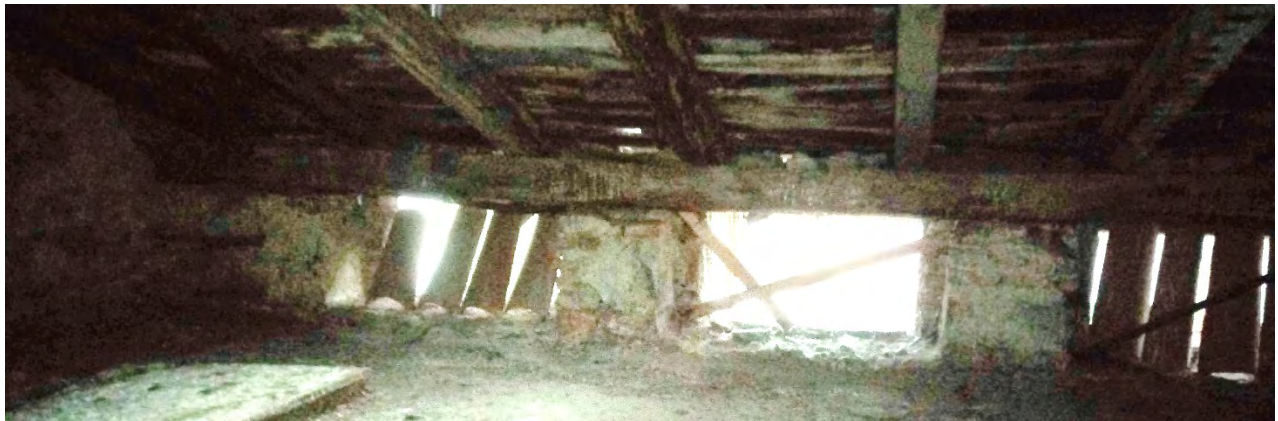
Figure 17:Fronte esterno facciata corte interna; pertugi sotto sbalzo di gronda che verranno chiusi (vista interna)
