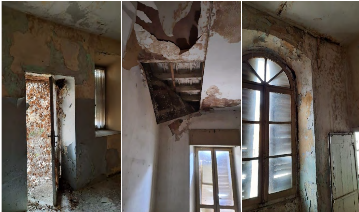
Figure 7: Locali con degrado dovuto alle infiltrazioni di acqua dalla copertura
