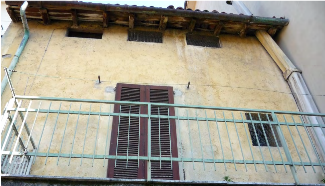
Figure 16:Fronte esterno facciata corte interna; pertugi sotto sbalzo di gronda che verranno chiusi (vista esterna)
