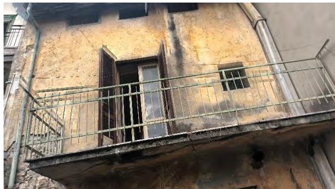
Figure 12: facciata corte interna. Vista: serramenti esistenti-parapetto-degradi mat. lapidei
