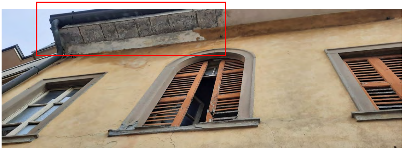
Figure 23: vista del particolare cornicione fronte IV Novembre, fessurazioni intonaco/muratura, esfoliazione davanzali in pietra
