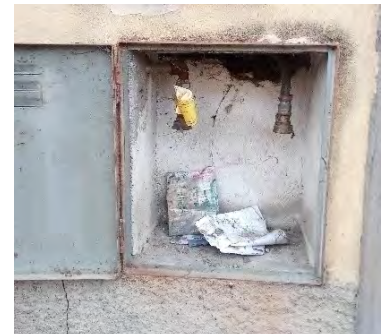
nicchia contatore GAS che verrà eliminata
