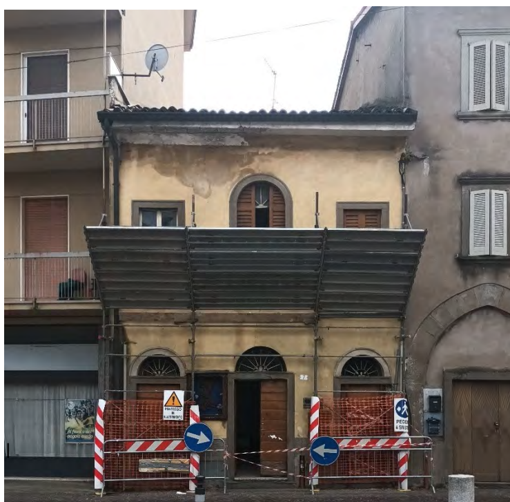
Figure 21: vista fronte piazza V Novembre foto recente del dicembre 2022 con nuovo apprestamento di sicurezza a protezione dei distacchi di intonaco e cornicione sotto-gronda
