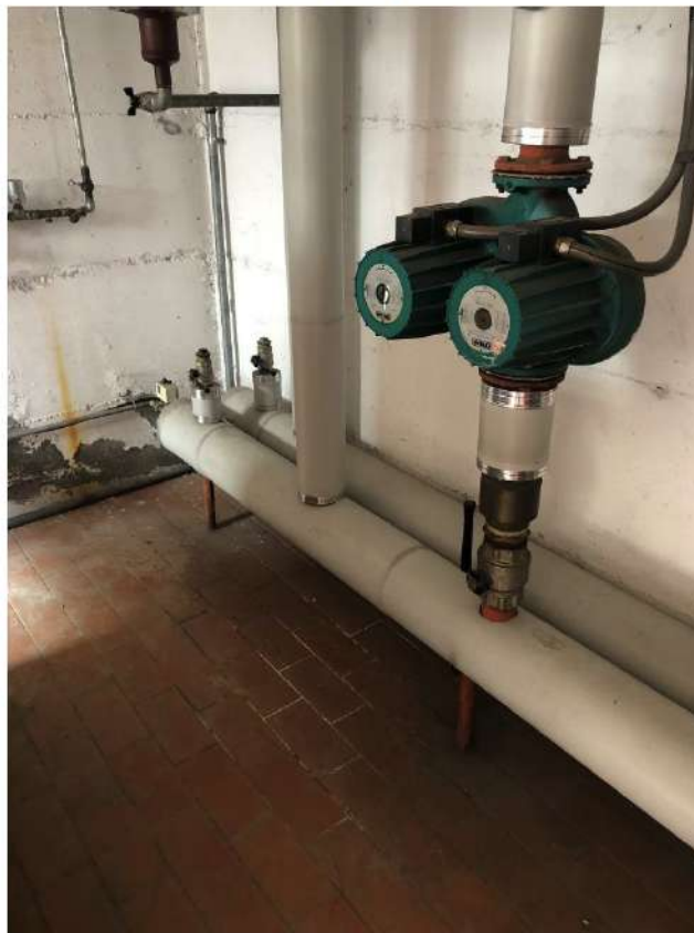
Pompe centrale termica
