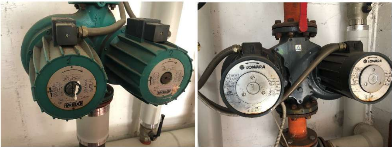
Pompe esistenti da sostituire
