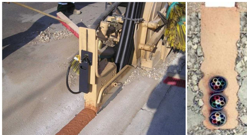
Esempio riempimento con conglomerato cementizio e sua colorazione (immagini da Norma UNI/PdR 7:2014)
